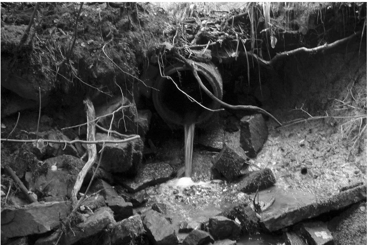
Dole zu hoch eingebaut und damit entgegen der Fließrichtung ein kaum überwindbares Hindernis
